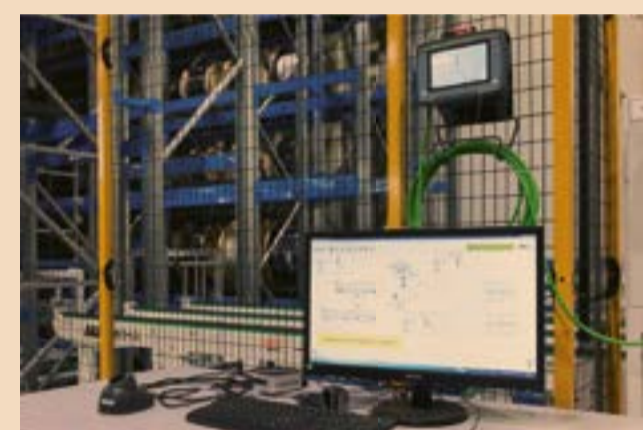
L'INTERFACCIA SCADA PERMETTE ALL'OPERATORE DI MONITORARE COSTANTEMENTE L'ATTIVITÀ ED IL FUNZIONAMENTO DEL MAGAZZINO
