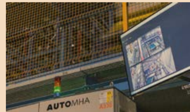
LA GESTIONE DEL MAGAZZINO TRAMITE AWM PERMETTE ALL'OPERATORE DI NON ENTRARE MAI NELL'AREA DI STOCCAGGIO, MIGLIORANDO COSÌ LA SICUREZZA DELL'AZIENDA
